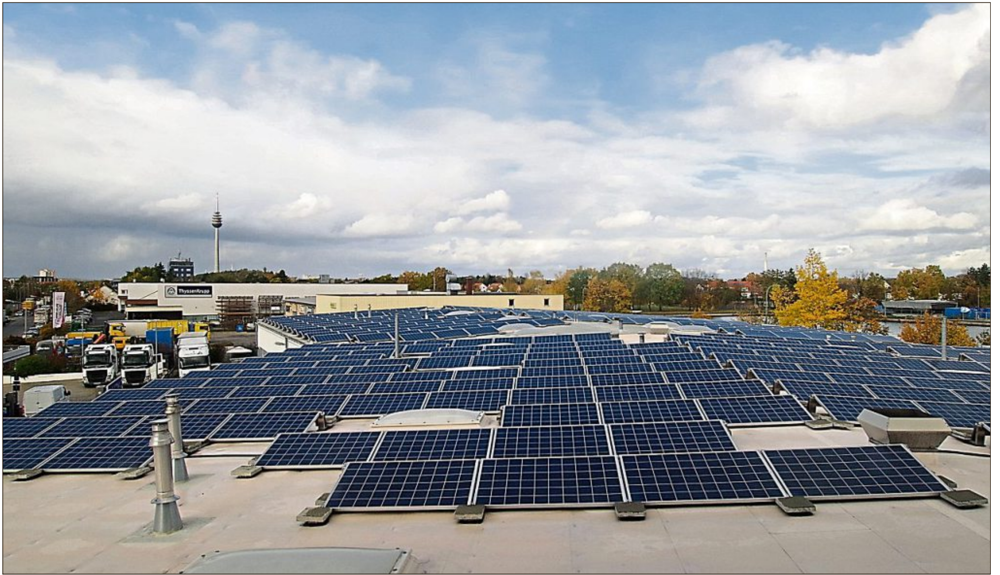
Schielein Busreisen ist Solarstrom-Vorreiter in Nürnberg: Etwa 50 Prozent des selbst erzeugten Solarstroms von ihrer Dachanlage nutzt das Unternehmen im eigenen Haus, nur der Rest wird ins Stromnetz eingespeist. FOTO: WRANESCHITZ
